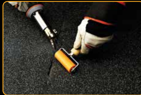
Elektrisch föhn DW 3000
